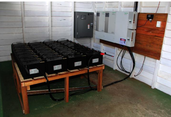
Instalações do sistema de geração de energia solar - Tumbira
